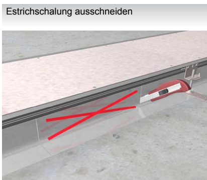
Estrichschalung ausschneiden Estrichschalung an einer Seite aufschneiden, so dass die Anschlussdose angeschlossen werden kann.
